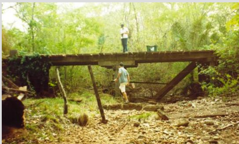
Foto 5:04 - Leito do Córrego Mato Seco Casarin, 2007
